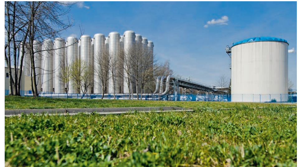
Zwei Riesen-Thermoskannen: So könnte eine flapsige Bezeichnung der beiden Speicher in Chemnitz lauten. Dort stehen der Kaltwassertank (vorne rechts) und der Warmwasserspeicher (hinten links) der sächsischen Eins Energie zur Versorgung der Innenstadt mit Fernkälte.
